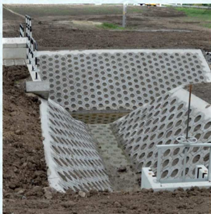
A Holt Ronyván kiépített kettős elzárású zsilipes műtárgy látképe
