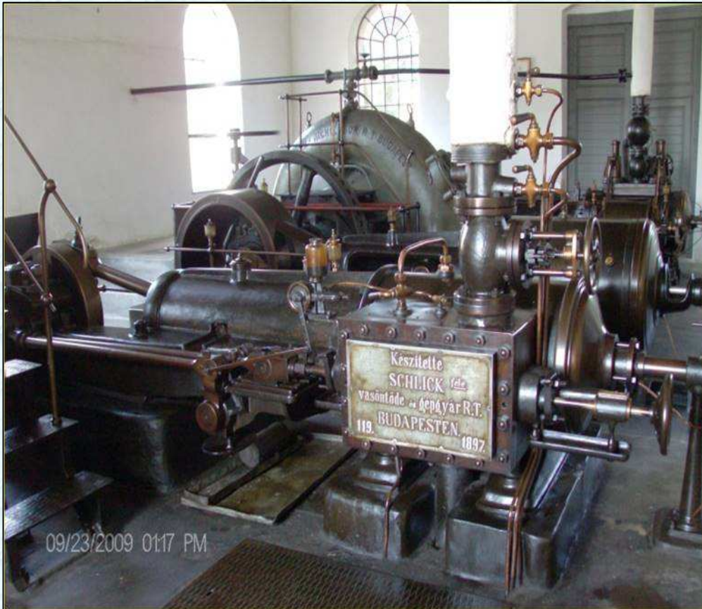
A Schlick-féle Vasöntöde és Gépgyár Rt. által 1897-ben készített szivattyú a Törökéri szivattyútelepen
