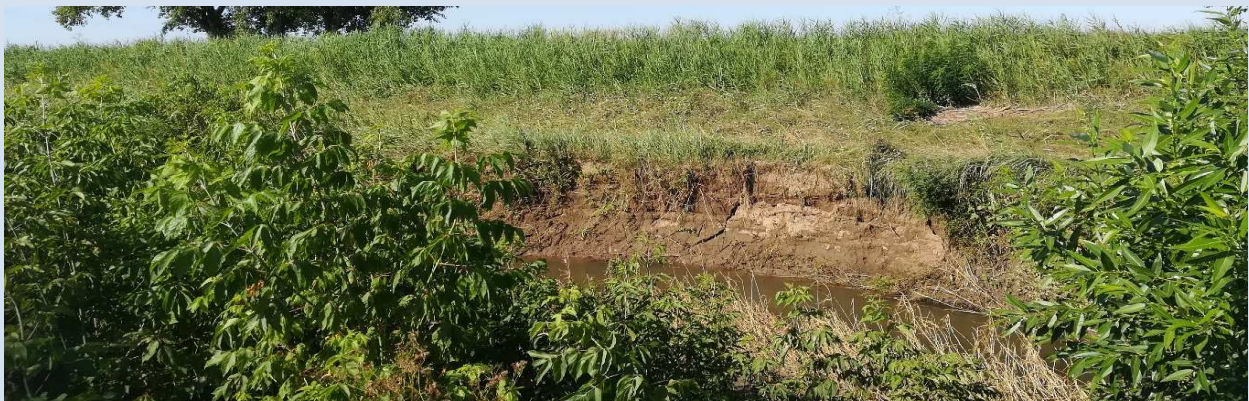
Árvízvédelmitöltés állékonyságát veszélyeztető partszakadás
