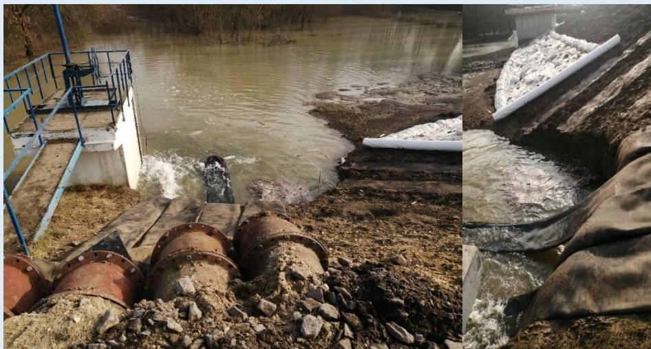
Hejőkürti szivattyútelepnél részbeni töltéselhabolás
