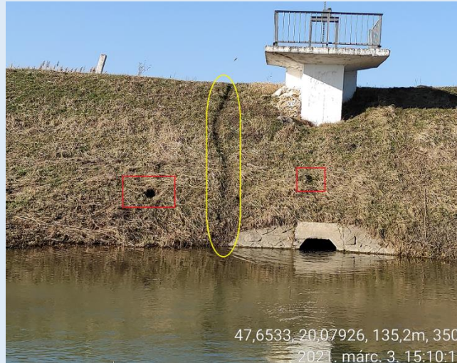
Hódyukak és hódjárat az árvízvédelmi töltés vízdali részűjén
